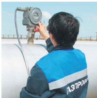
Рис. 3. Гигрометр серии «КОНГ-Прима» на магистральном газопроводе.
